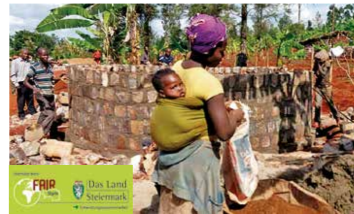
Die neue Wasserentnahmestelle vereinfacht auch den Alltag vieler Frauen, die für die Wasserversorgung der ganzen Familie zuständig sind.
